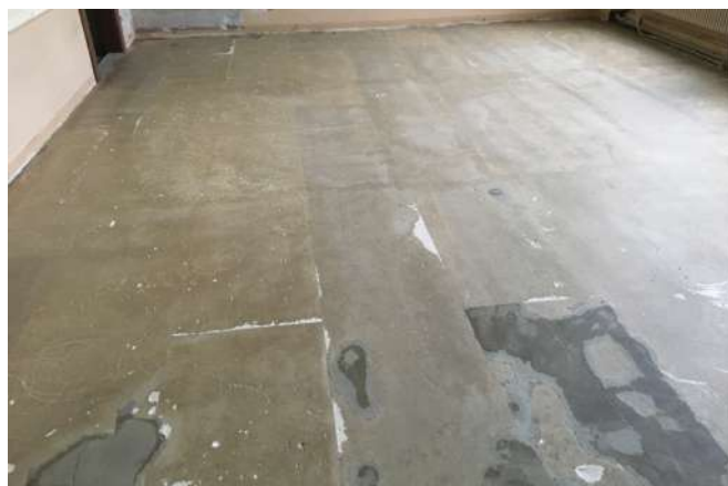
Oude ondergrond die moet worden gerenoveerd.
